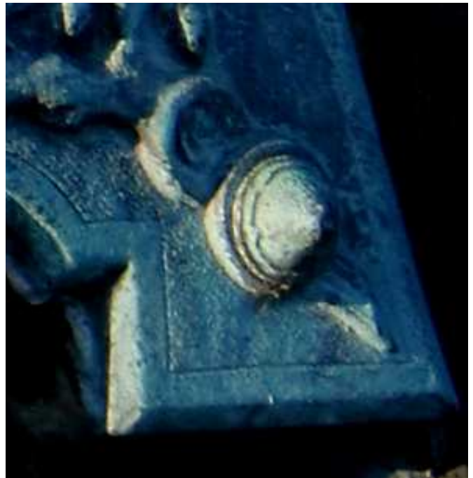
So sah die alte Schutzkappe direkt vor dem Ausbau am unteren rechten Rand der Bronzetafel aus
